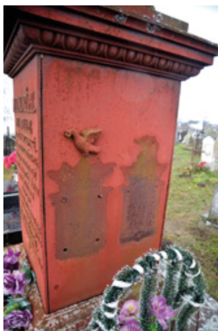
Widoczne ślady po czterech, zerwanych przez wandalów, tablicach inskrypcyjnych związanych herbem rodzowym Trębickich «Śłopwron» po prawej i lewej stronie cokola kolumny
